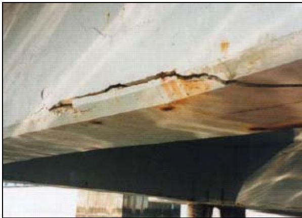
Gambar 3 Kondisi kerusakan pada waktu T_{III} [6]
